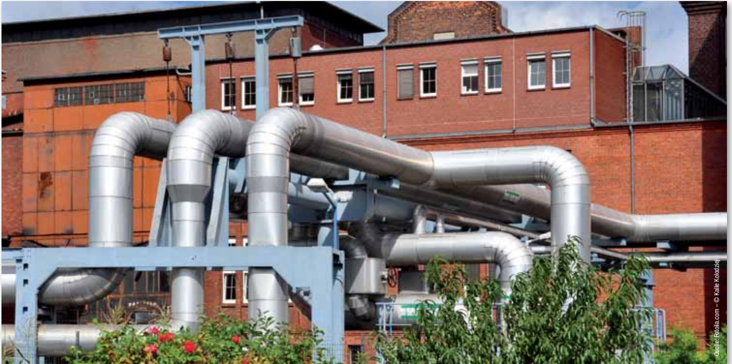
Bei der Bedienung von Haustechnikanlagen fällt der Blick oft auf die klar lesbaren Anzeigen der von GEVA gelieferten Bedienterminals und Lösungen für die Prozessvisualisierung.
